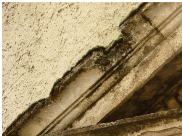
Détail du fronton portant les marques de l'orage de grêle de juillet 1892
